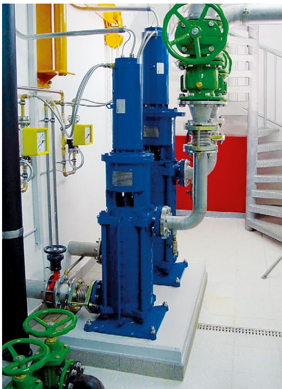
Exemple d'un pompage pour le raccordement de 2 réseaux d'eau communaux.
