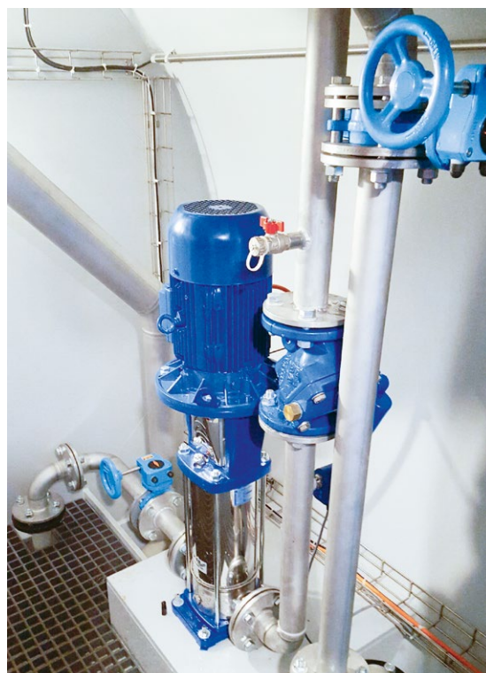
Exemple de pompe pour l'adduction d'eau potable d'une source communale.
