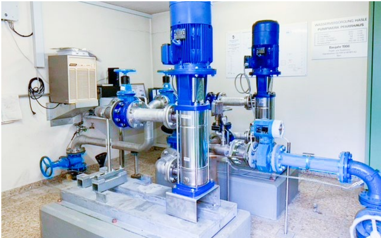
Alimentation en eau (station pompage) Hasle près Berthoud
