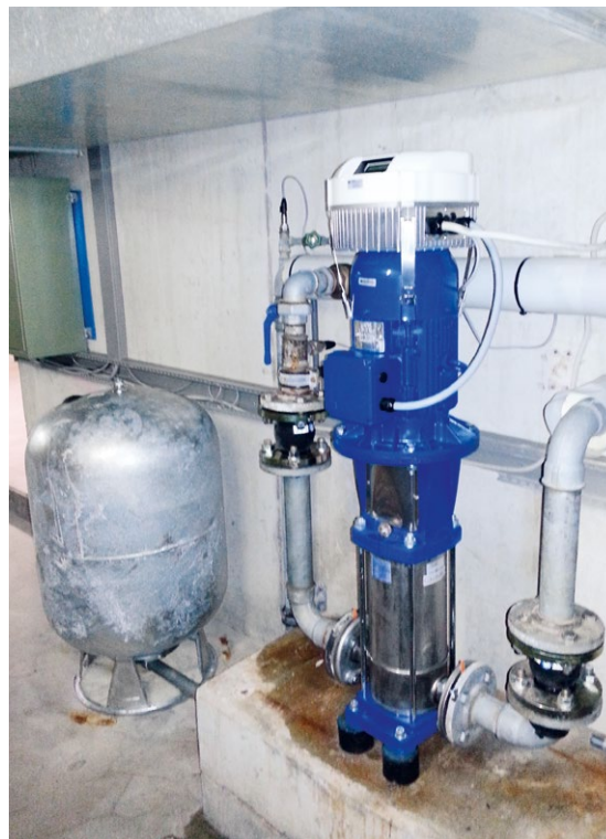
Exemple d'un surpresseur avec système Hydrovar pour un bâtiment d'utilité publique.
