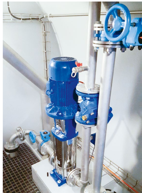
Beispiel einer Pumpe zur Einspeisung von Trinkwasser ins Wassernetz aus einer Quelle.
