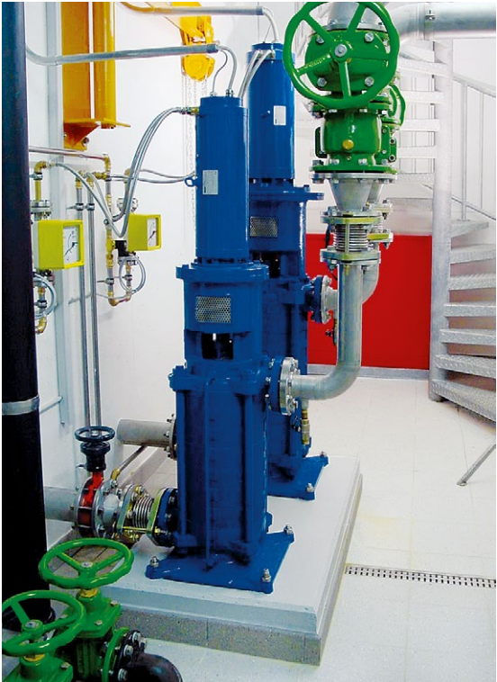
Geräuscharme Druckwasserversorgung einer Gemeinde mit wassergekühlten Motoren
