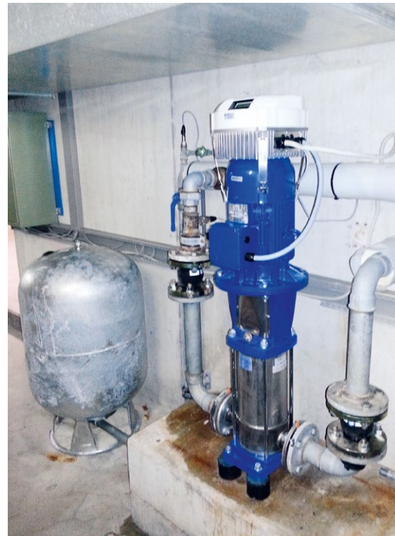
Beispiel einer Druckerhöhungsanlage mit Hydrovar-Regelsystem in einem öffentlichen Gebäude.
