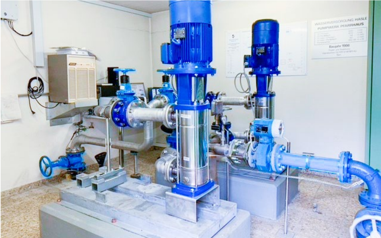
Wasserversorgung (Pumpwerk) Hasle bei Burgdorf
